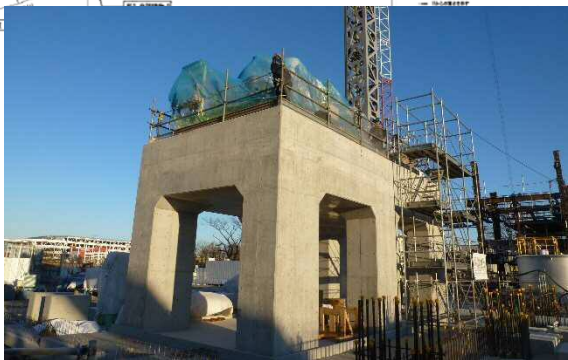
蒸気タービンの基礎
